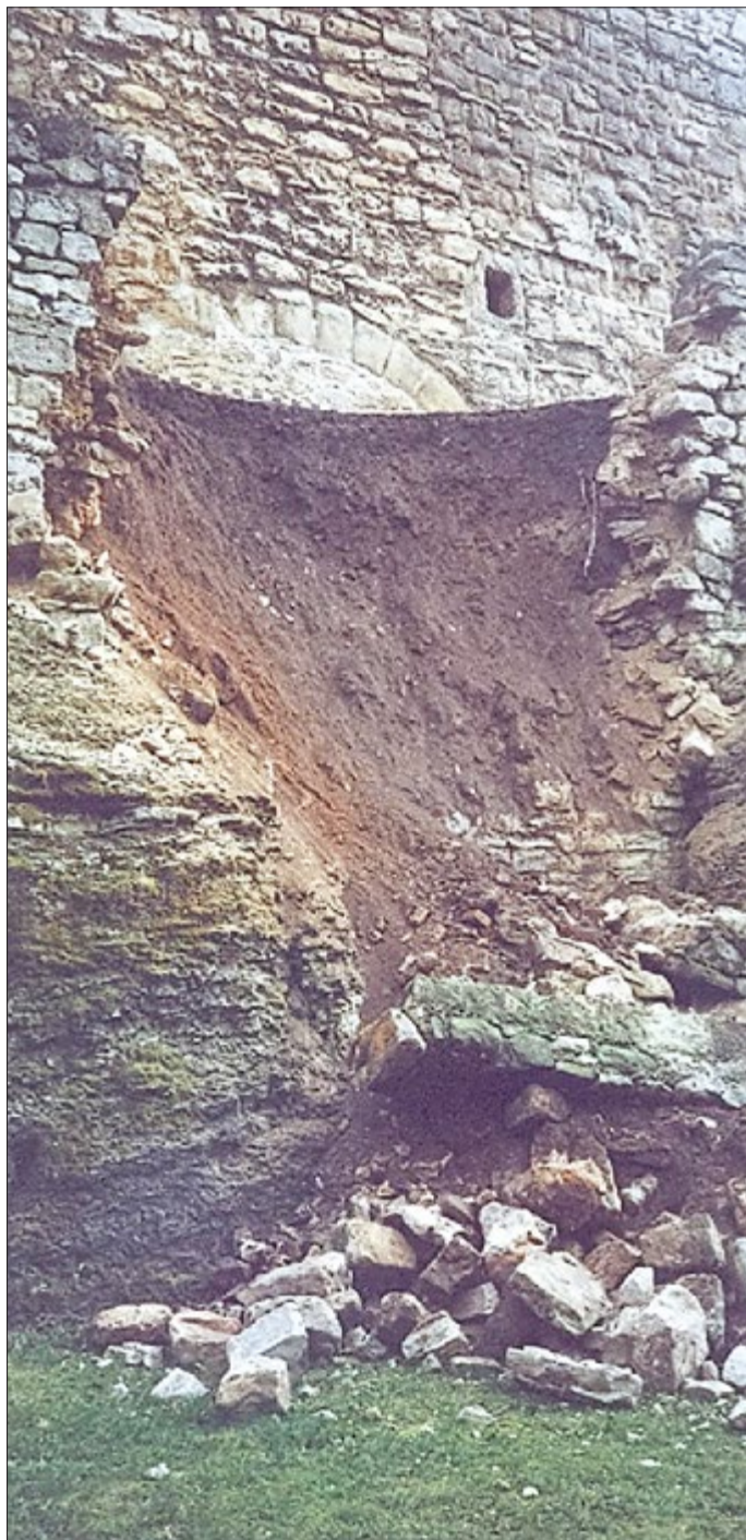
Mauerschaden im Brunnengraben
