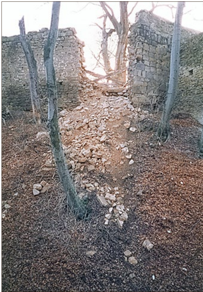
2000 - Einsturz großer Burghof - Nordmauer
