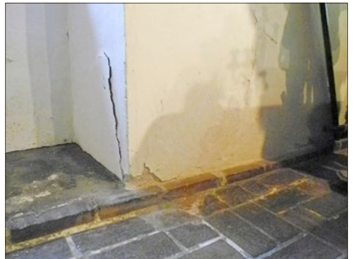
Putzschäden im Vereinszimmer
